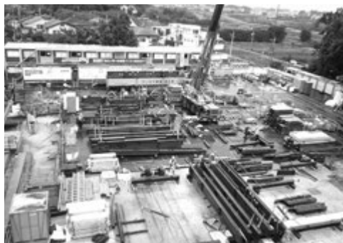
図14：H30.9.1 本館工事の完全な資材置き場状態が約1年間。
